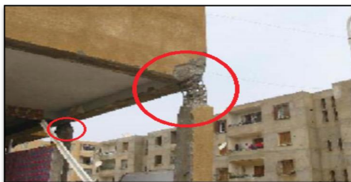
Figure 1.1 : Ruine d'un poteau (rotule plastique) après le séisme Boumerdes 2003 [4].
