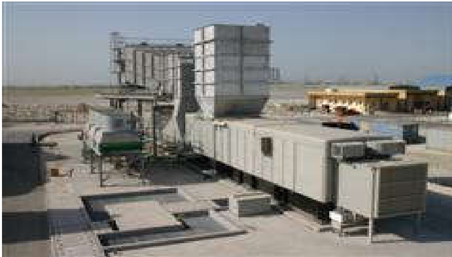
Figure III.27 : Turbine GE MS 5001P dans la station de production d'électricité M'sila
