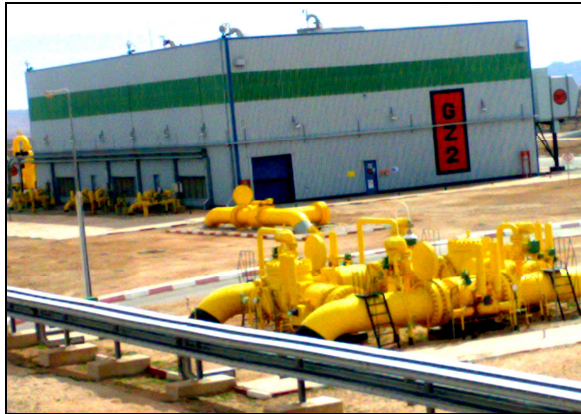
Figure IV.1: Gazoduc GZ2 de centrale M'seka SONATRACH
