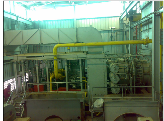
Figure IV.2 : Turbine à gaz GE MS -3002-TC 201
