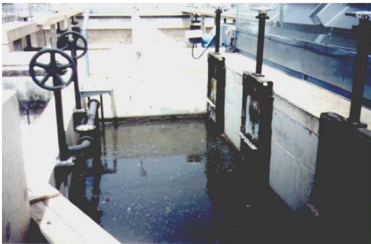
Fig. III.5. Dégrillage grossier de la station d'épuration
