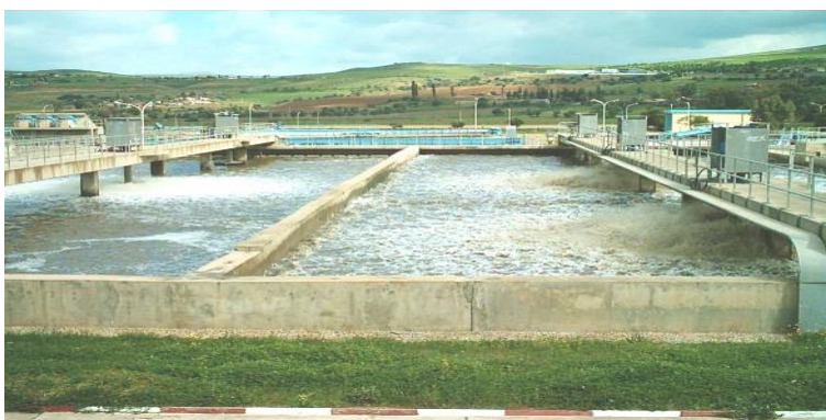
Fig. III.7 : Bassin d'aération de la station d'épuration
