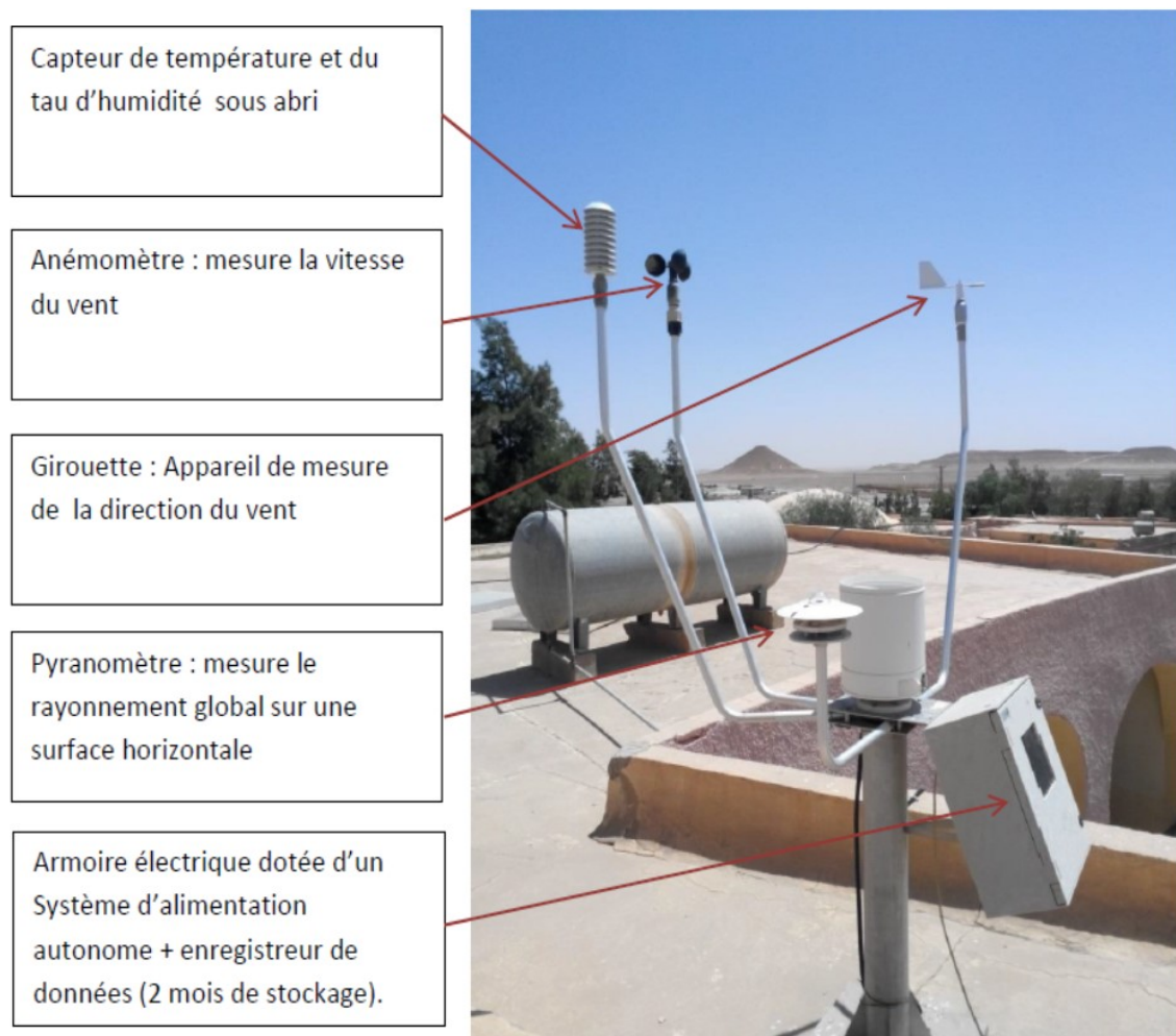
Figure (3- 7): Les capteurs météorologiques installée sur le toit de l'URAER (Ghardaïa).
