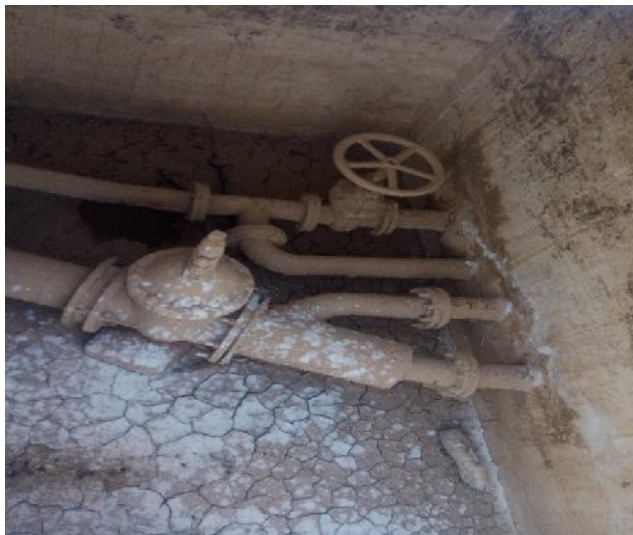
Figure 32 : chambre de vannes R1
