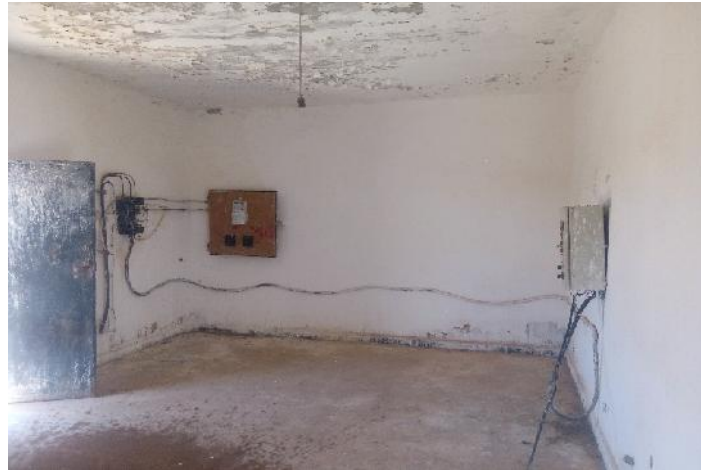
Figure 21 : Equipements électrique Forage F2
