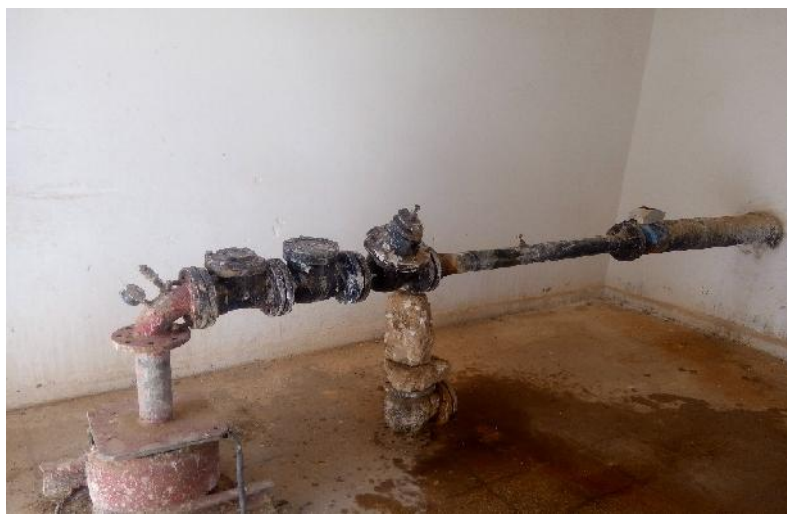
Figure 22 : Equipements hydrauliques Forage F2
