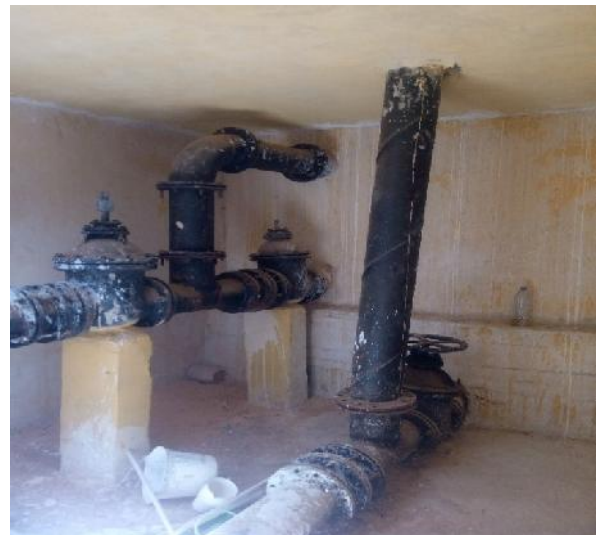
Figure 33 : chambre de vannes R2
