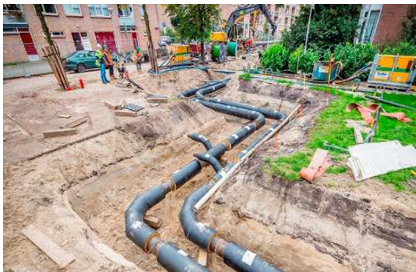
Réseau de chaleur urbain Amsterdam (Source : Agence Parisienne du climat)
