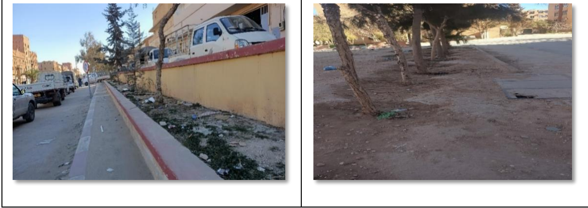
الصورة (23): إهمال أعمال صيانة الرصيف وانعدامها (إلتقاط الطالب، مارس 2022)
