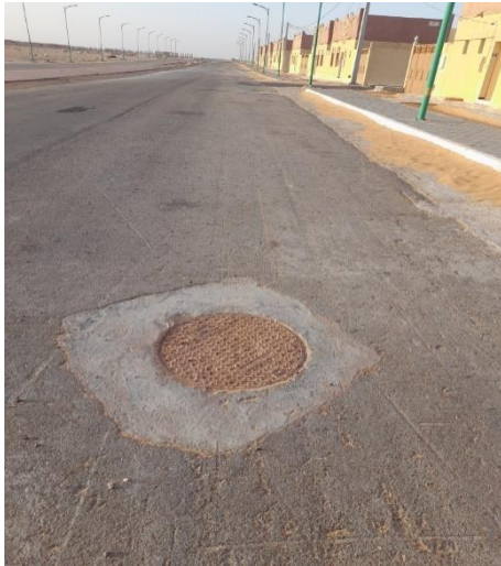
الصورة رقم -28- صور لمشعبات الصرف الصحي
