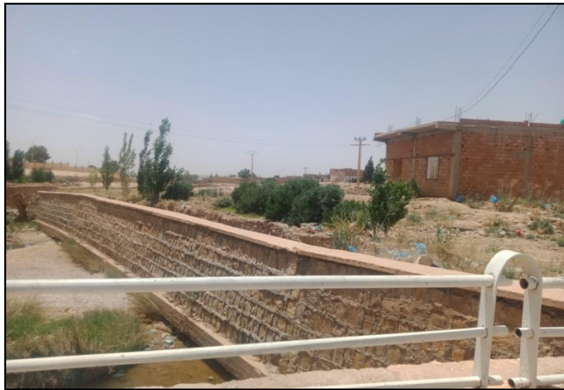
الصورة رقم (22): بناية لم تحترم ارتفاع الواد
