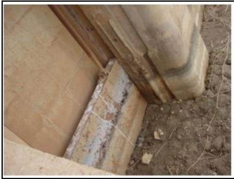
Figure 19 : Blocage des vannes de fond (Remini, 2011).
