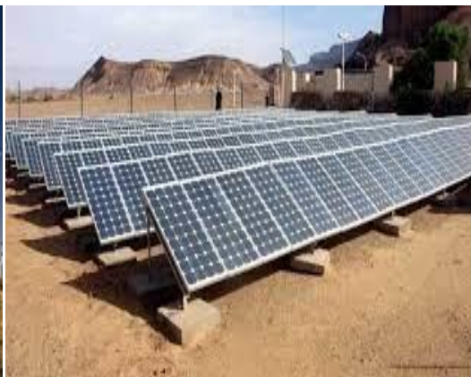
photos 21 :panneaux solaires Source :Algeria éco
