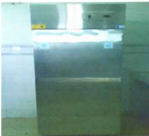
Photos N°09 : Chambre Froide
