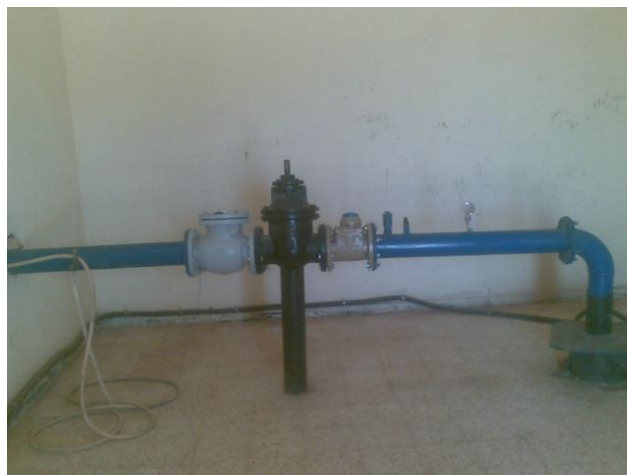
Photo 2 : Vue intérieure du forage
