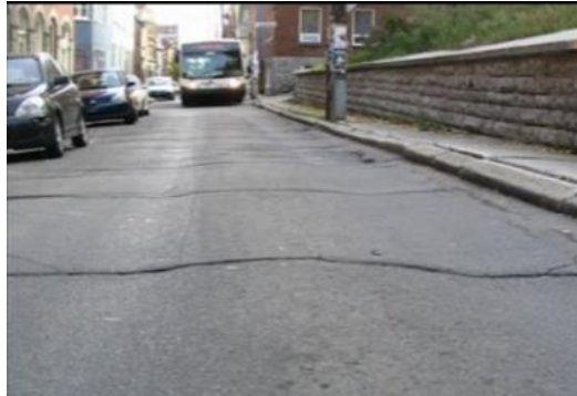
(a) Fissuration longitudinale
