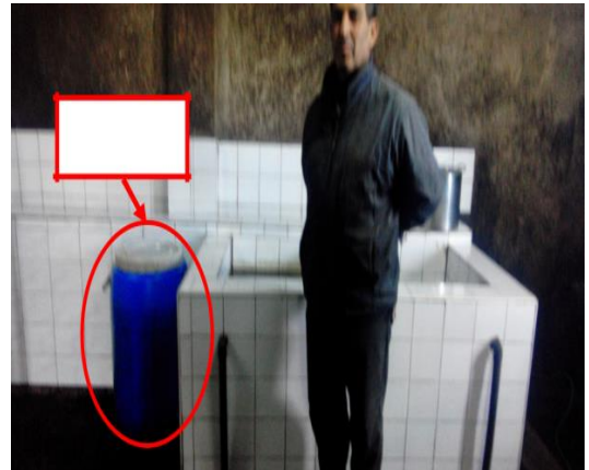
Photo 09: Nageoire de décantation et de séparation de l'huile (500-600 cm 3 ) et fûts de stockage.
