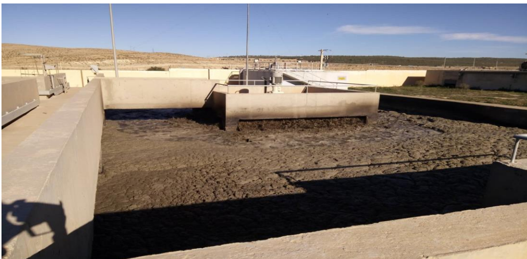
Figure III.10 : Bassin d'aération file existant
