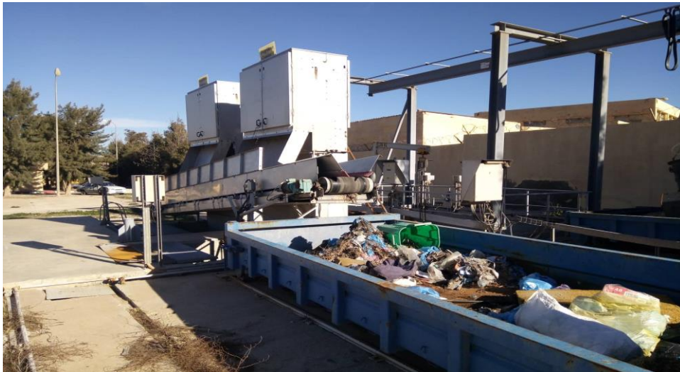
Figure III.3 : Dégrilleur grossier automatique
