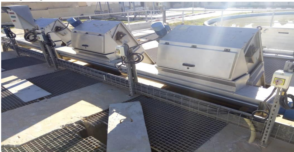
Figure III.5 : Dégrillage fin automatique
