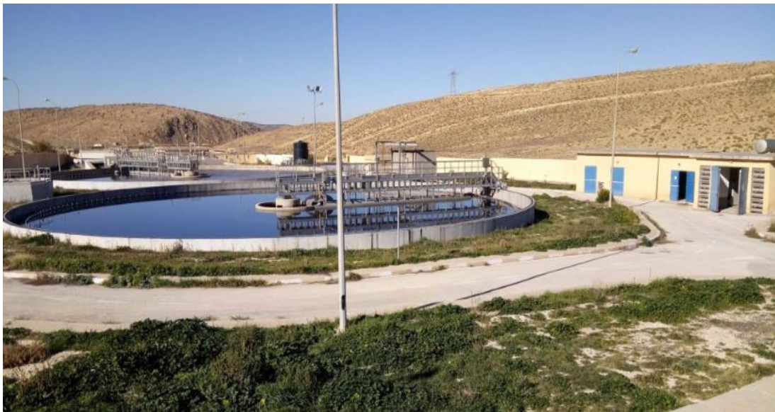
Figure III.15 : Décanteur secondaire nouvelle file
