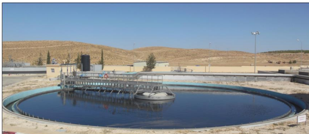
Figure III.11 : Décanteur secondaire (clarificateur) file existante
