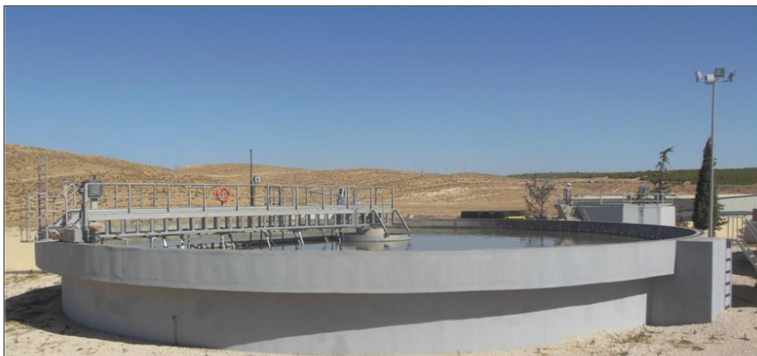
Figure III.13 : Décanteur primaire nouvelle file
