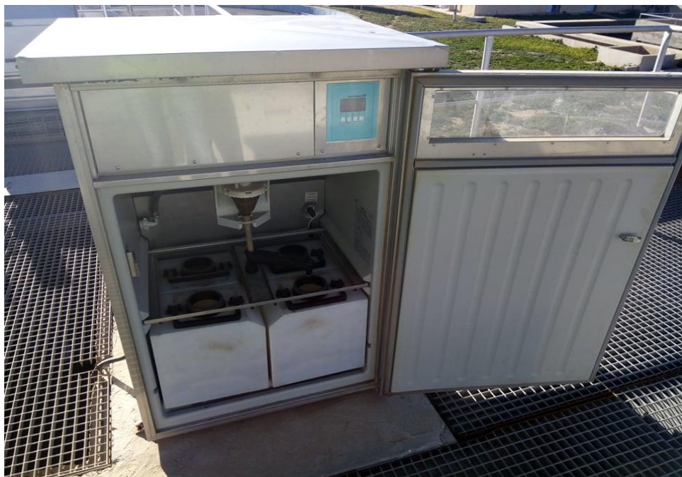
Figure III.6 : Préleveur d'échantillons automatique
