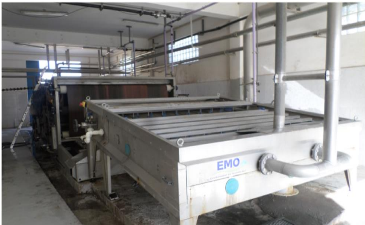
Figure III.18 : Tables et presses à bandes
