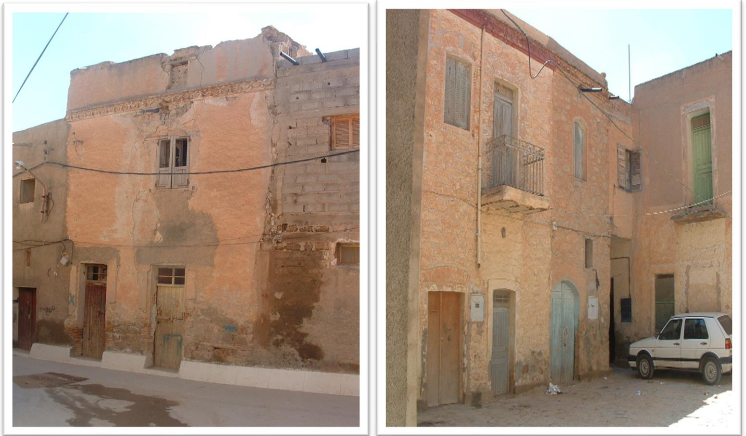
Figure 26 : l'état des logements
