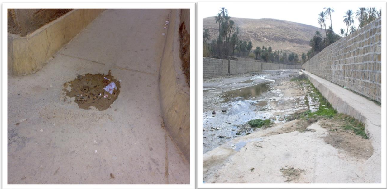
Figure 21 : l'état de réseau d'assainissement
