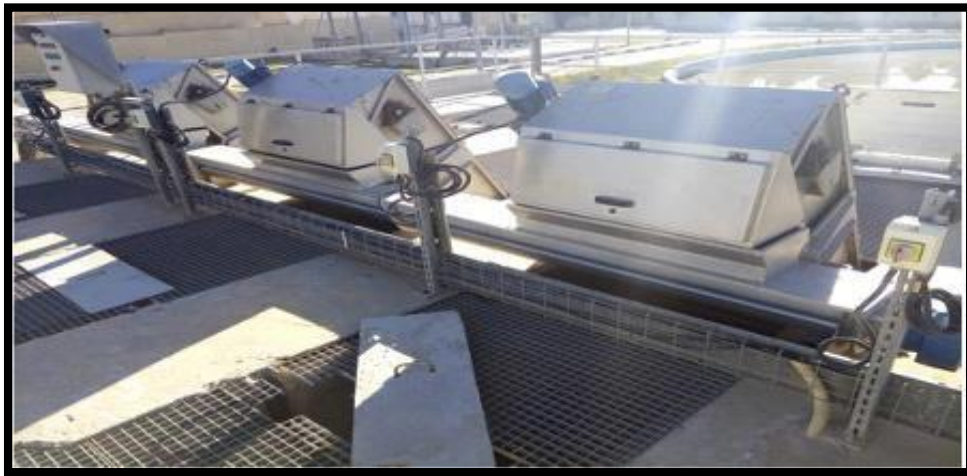
Figure 07 : Dégrillage fin automatique (Juillet 2021)
