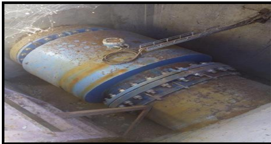
Figure 06: Débitmètre électromagnétique (Juillet 2021)
