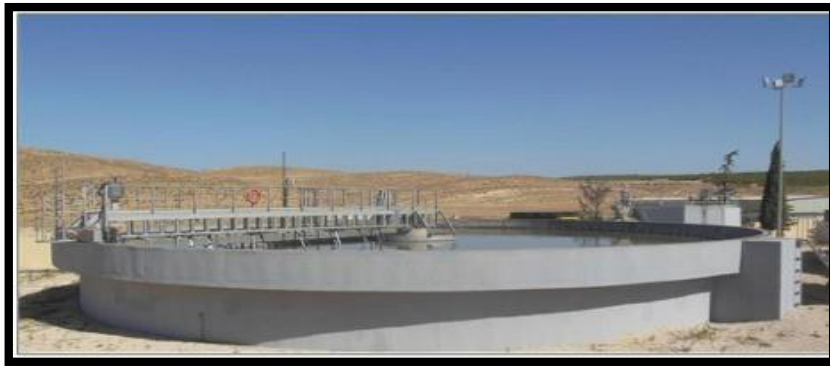
Figure 15 : Décanteur primaire nouvelle file (Juillet 2021)
