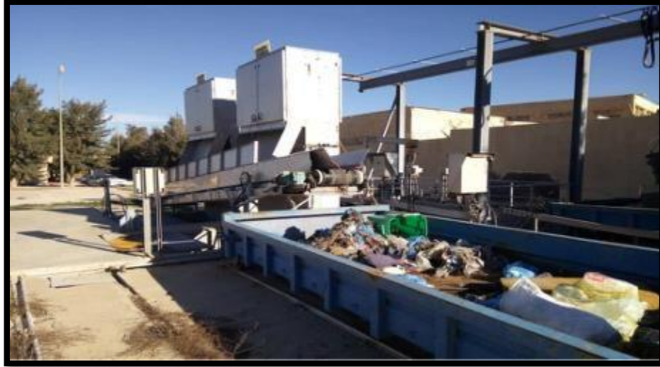
Figure 05 : Dégrilleur grossier automatique (Juillet 2021)
