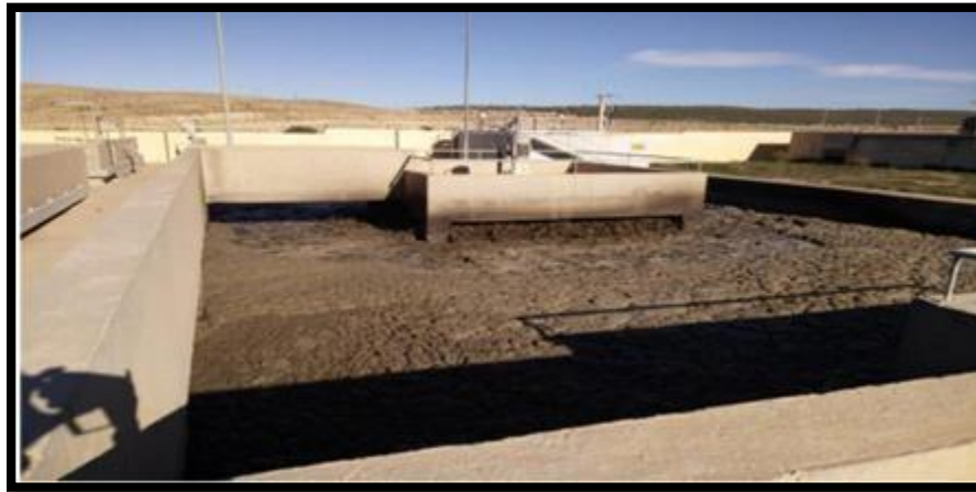
Figure 12 : Bassin d'aération file existant (Juillet 2021)
