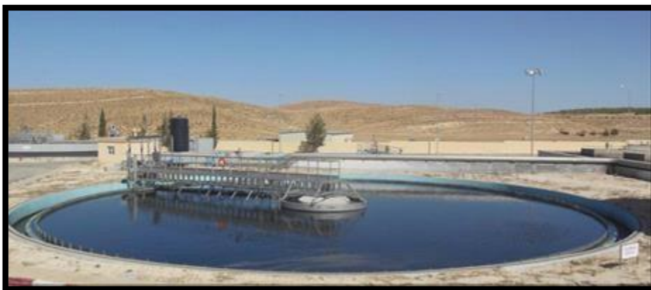
Figure 13: Décanteur secondaire (clarificateur) file existante (Juillet 2021)
