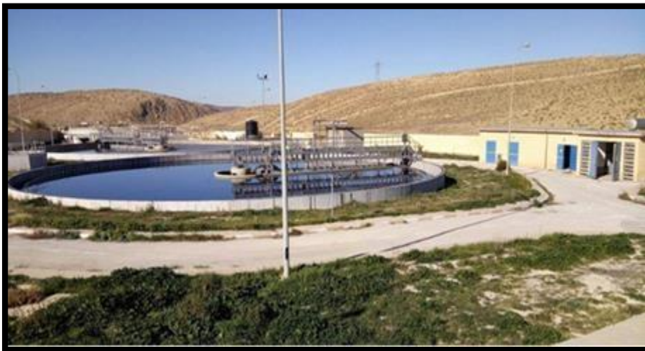
Figure 17: Décanteur secondaire nouvelle file (Juillet 2021)
