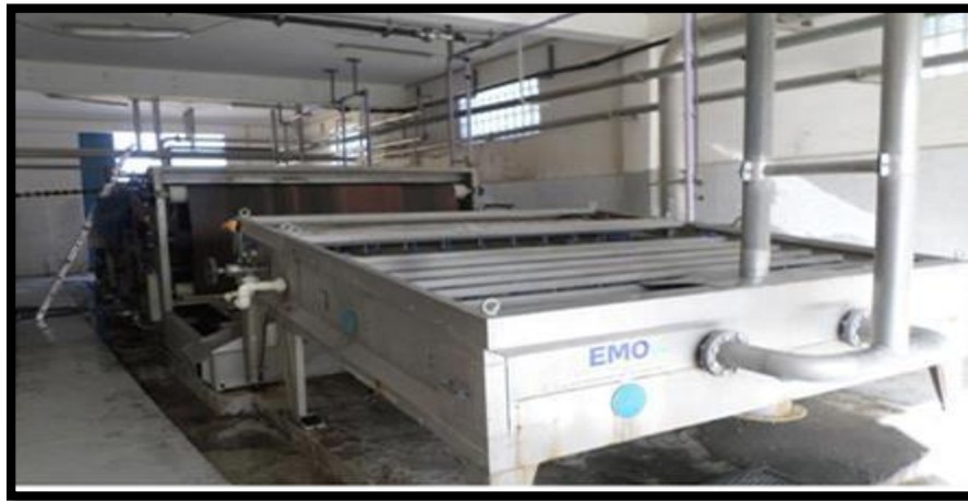
Figure 20 : Tables et presses à bandes (Juillet 2021)
