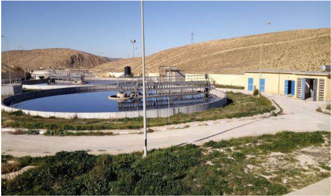
Figure IV.14 : Décanteur secondaire nouvelle file
