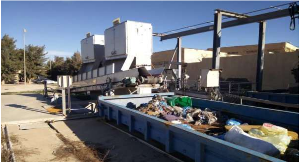
Figure IV.3 : Dégrilleur grossier automatique
