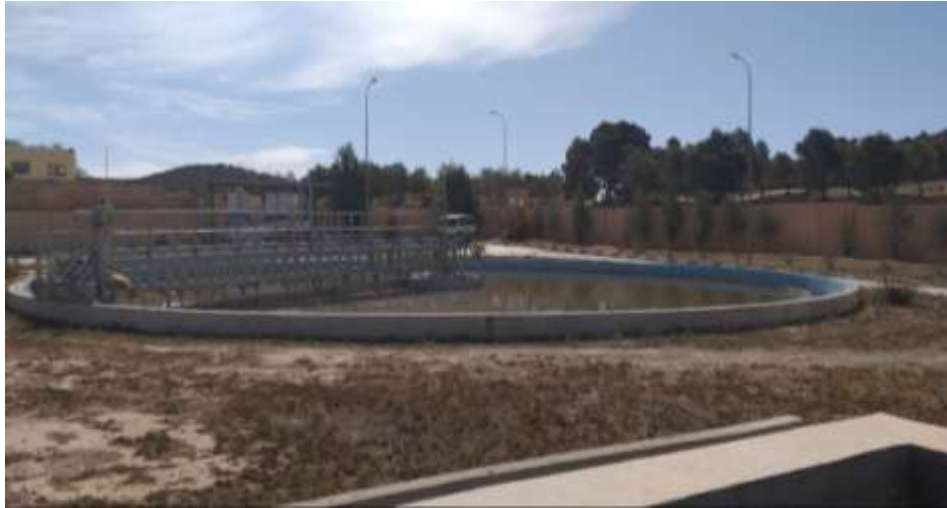
Figure IV.8 : Décanteur primaire file existant
