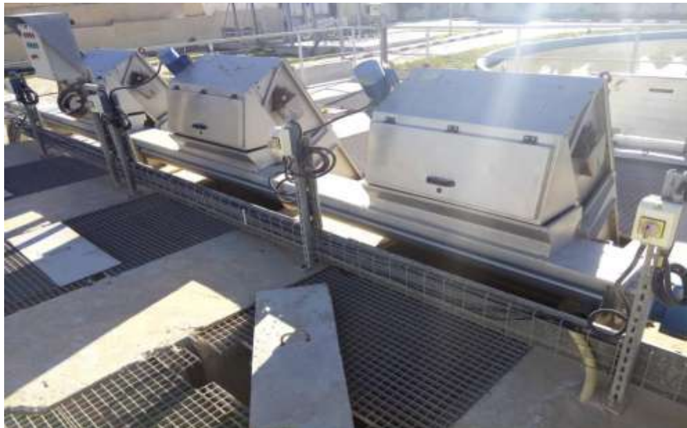
Figure IV.4 : Dégrillage fin automatique
