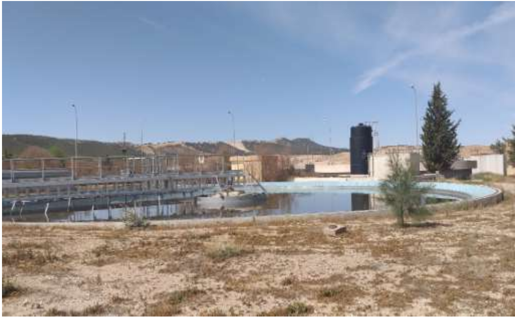
Figure IV.10 : Décanteur secondaire (clarificateur) file existante
