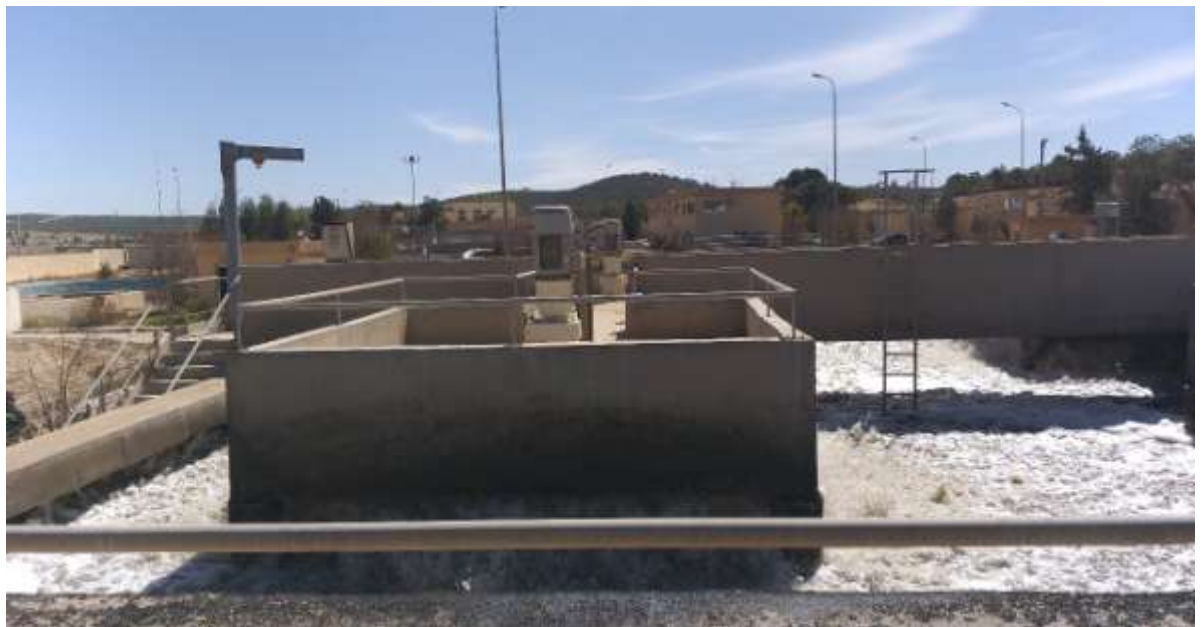
Figure IV.13 : Bassin d'aération nouvelle file
