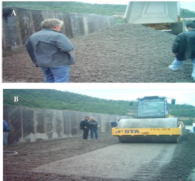
Figures II.6 : A-Etat du BCR frais lors de son déversement (Barrage Errmil Tunisie), B- Compactage du BCR (Barrage en BCR Errmil - Tunisie) (Zdiri 2008).
