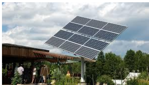
Fig.1.3 : Générateur photovoltaïque constitué de plusieurs panneaux solaires [2136]
