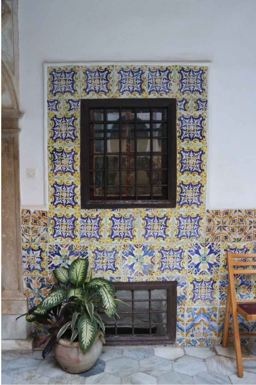
صورة 32 : إطار نافذة (نموذج 2 من الطابق الأرضي)
