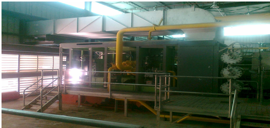
Figure IV.27 : turbine à gaz MS GE 3002 examinée
